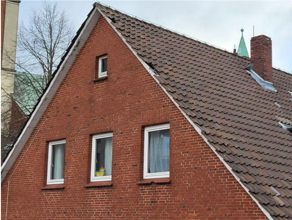
Foto 9: Beschädigtes Dach von Hausnummer 8 (Blick von Südwesten)
