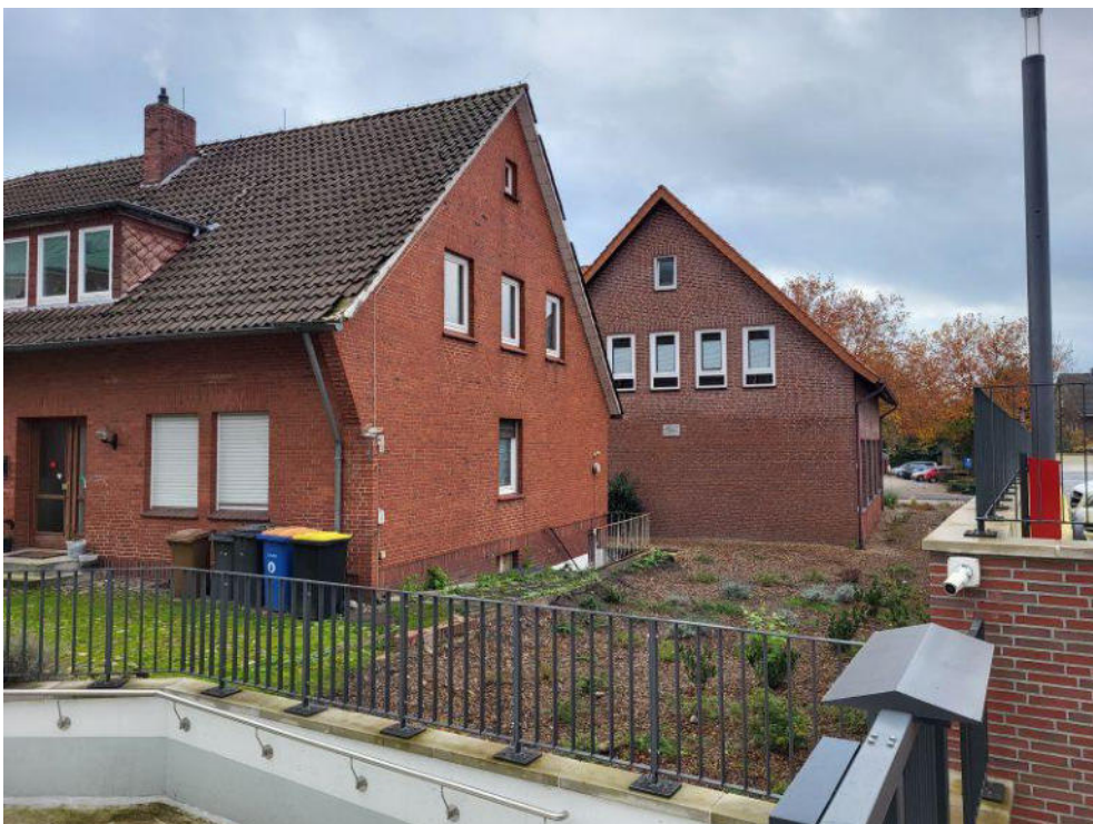
Foto 10: Beschädigtes Dach von Hausnummer 8 (Blick von Nordwesten)
